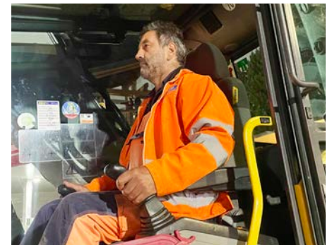
Ob sich die Baggerführer Harry und Christian wohl bewusst sind, dass sie historische Fundamente beseitigen?
