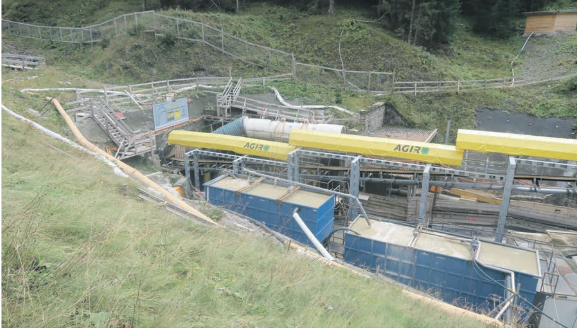
Beim Tunnelvortrieb (z.Zt. bei ca. 1112 Metern) fällt sehr viel Wasser an, das entsorgt wird.
