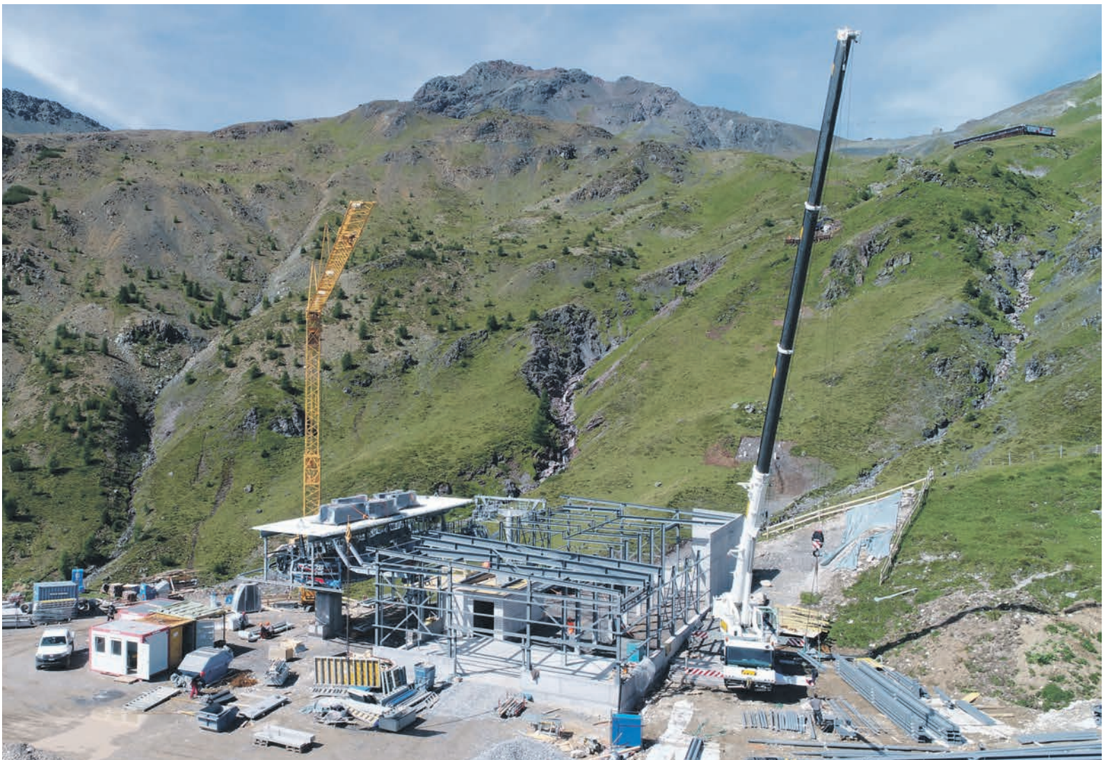
Im Parsennggebiet wird in diesem Sommer am neuen Furkalift gebaut. Noch bequemer...! Foto snow-world.ch / Marcel Giger
